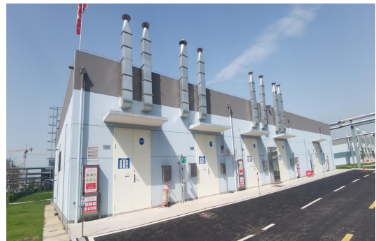
危险品库通风换气设施
