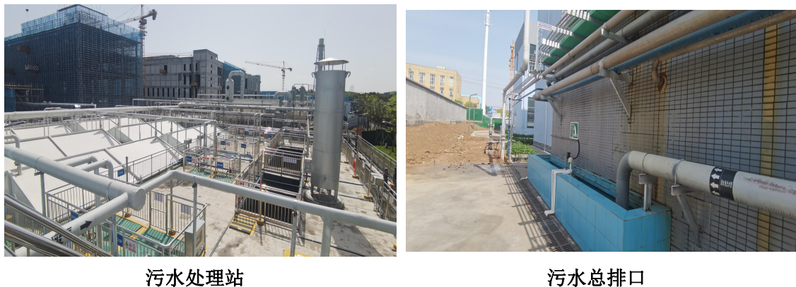
图 4.1-1 项目废水处理设施现场照片
