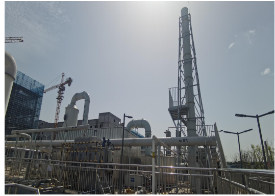
污水站废气处理装置及排气筒 DA002
