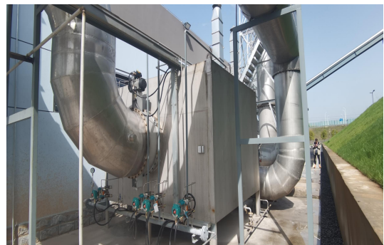
危废间废气活性炭吸附装置
