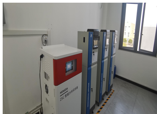
废水在线监测设施
